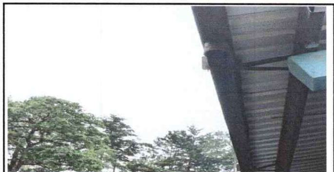
FOTO 1.2 : SUSTICION DE CANAL BAJADA DE AGUA PLUVIAL
