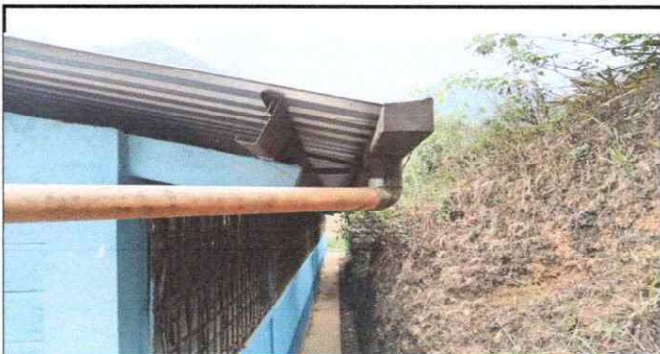
FOTO 1: SUSTICION DE CANAL BAJADA DE AGUA PLUVIAL
